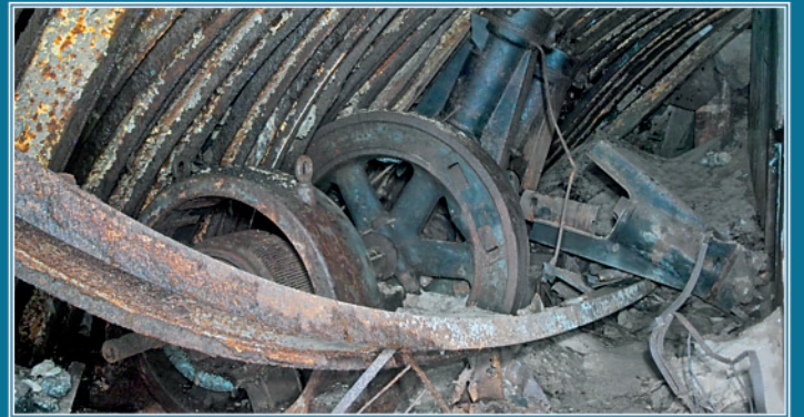
Под рухнувшим перекрытием силовой станции находятся два разбитых трёхцилиндровых шведских дизель-генератора
